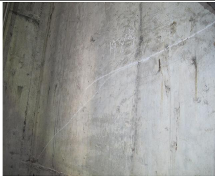
환기구 7번 벽체 균열(cw=0.2mm)
