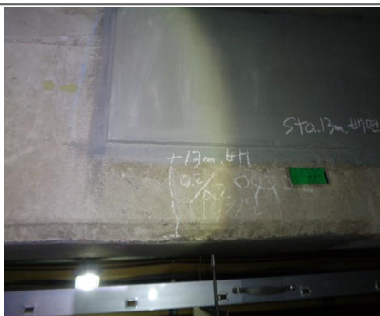
폐 작업구 균열(0.3mm미만)
