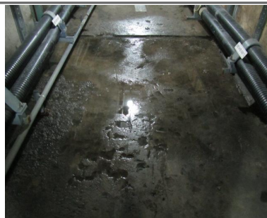
의사당로A 전력구 체수 (STA. 134m~137m)
