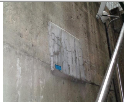
작업구 2번 보수부 망상균열
