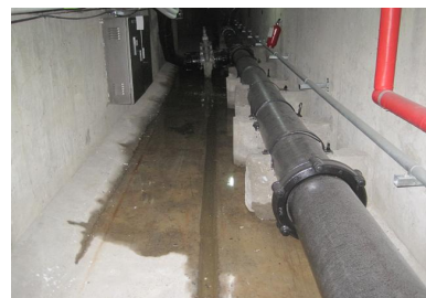
금용로 통신구 체수 (STA. 388m~391m)
