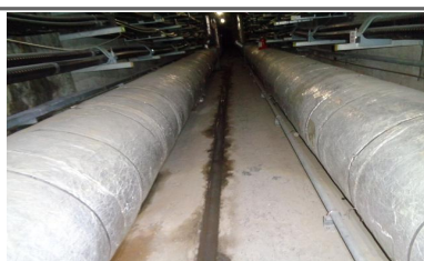
순환선 전력구 체수 (STA. 1,610m~6,689m)
