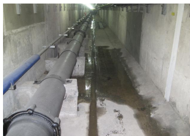
금용로 통신구 체수 (STA. 360m~380m)
