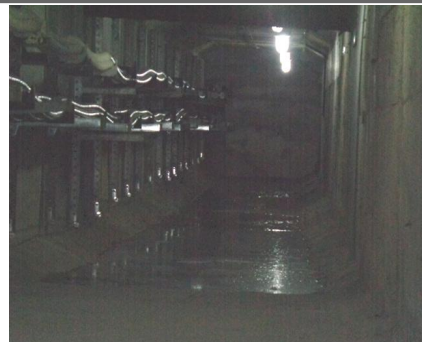
순환지선 전력구 체수 (STA. 30m~39m)
