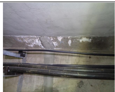
전력구 0K072 상부슬래브 백태(b)(0.3m×2.0m)
