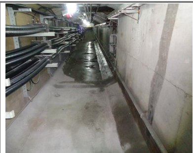
의사당로A 통신구 체수 (STA. 46m~52m)
