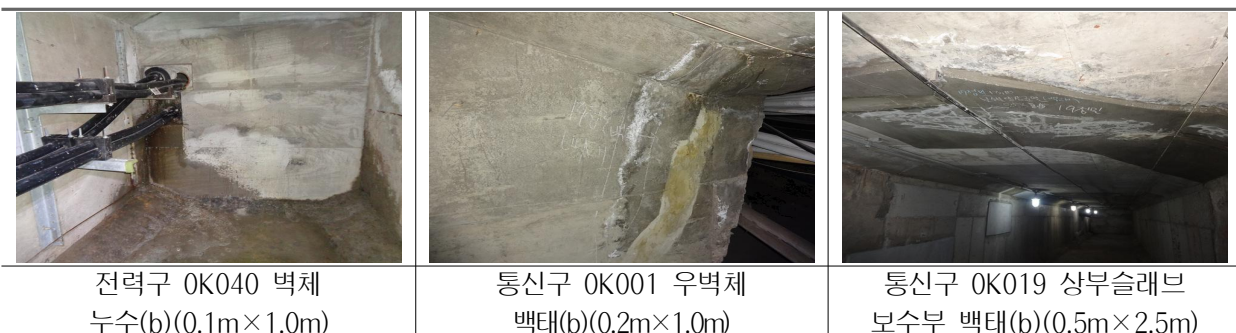
[사진 3.2.11] 누수/백태 손상사진
