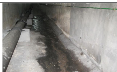
순환선 통신구 체수 (STA. 3,000m~3,020m)
