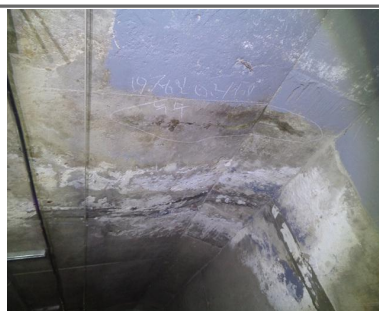
전력구 0K061 상부슬래브 누수(b)(1.0m)
