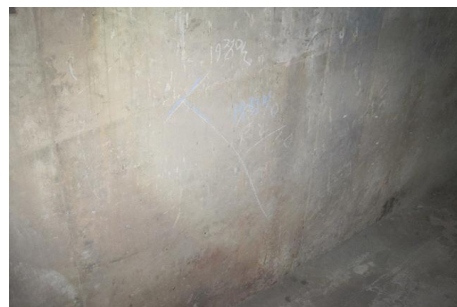
폐 작업구 20번 균열(cw=0.2mm)
