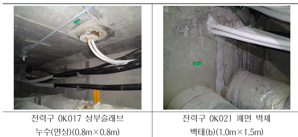
[사진 3.2.35] 누수 및 백태 손상사진
