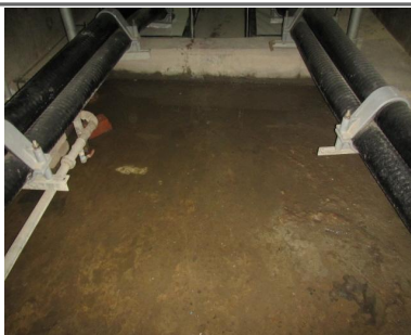
의사당로A 전력구 체수 (STA. 60m~63m)
