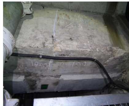
환기구 3번 균열
