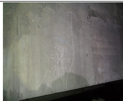
폐 작업구 3번 균열
