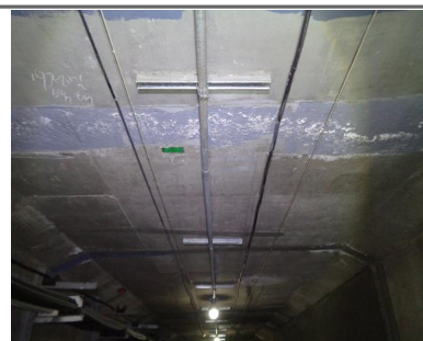
전력구 0K047 상부슬래브 보수부 백태(b)(0.4m×3.0m)
