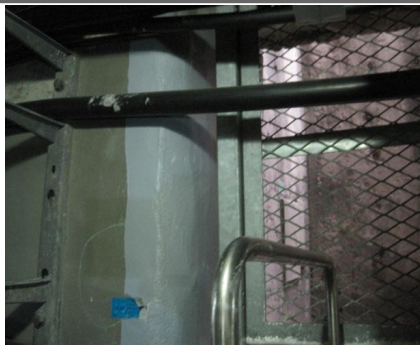
환기구 25번 벽체 보수부 박리 보수
