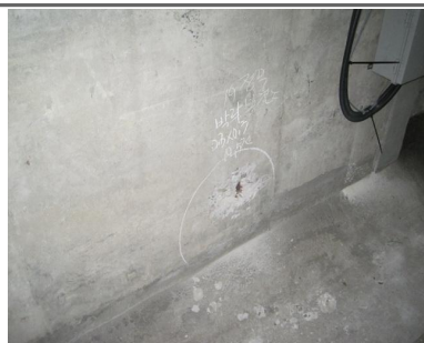
통신구 Sta.66m 철근노출(0.3m×0.3m)
