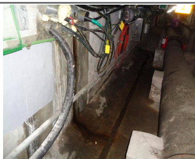
의사당로B 통신구 체수 (STA. 164m~171m)
