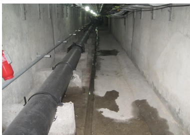
금용로 통신구 체수 (STA. 340m~360m)
