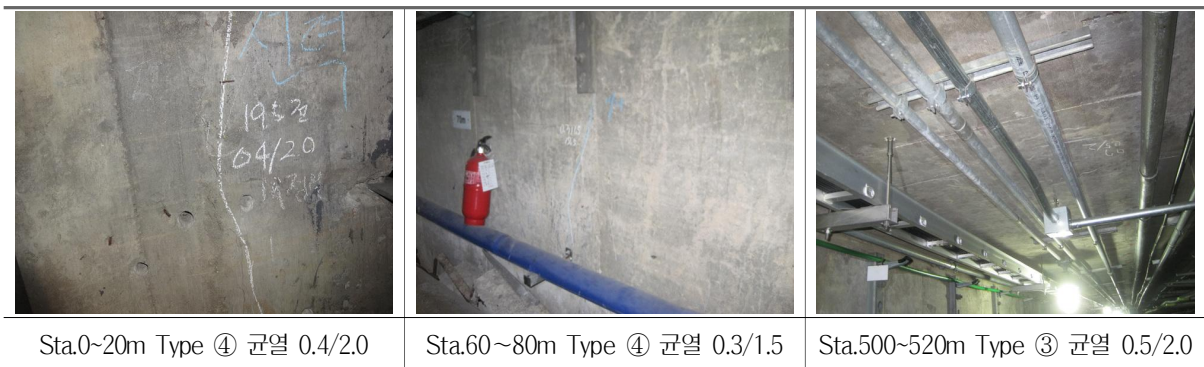
[사진 3.2.17] 균열폭 0.3mm이상 균열 손상사진
