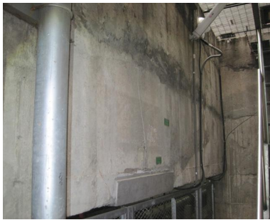
작업구 6번 수직균열
