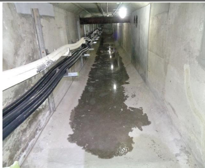
순환지선 전력구 체수 (STA. 10m~20m)
