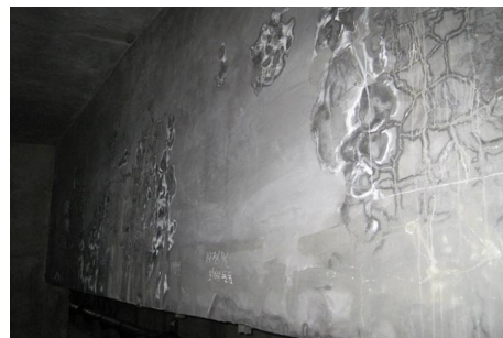
폐 작업구 14번 보수부 들뜸 및 누수
