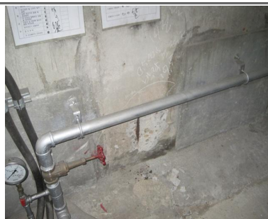
통신구 Sta.70m 철근노출(0.5m×0.5m)
