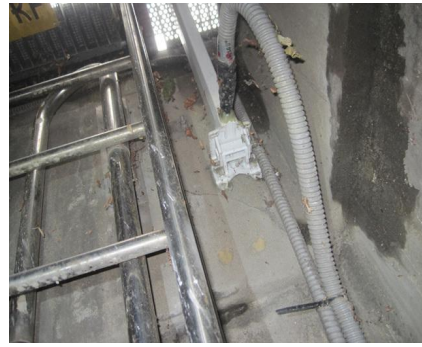
환기구 1번 보수부 균열
